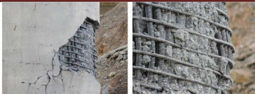
10-rasm. Nurdagi viadukining diametri 3 m bo'lgan temir-beton tayanchida kuzatilgan plastik deformatsiyalar
